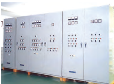
コントロールセンター
