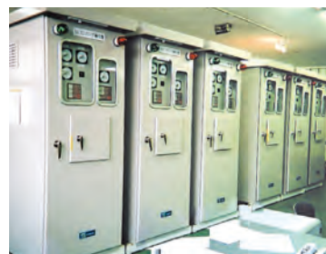
ゲート操作盤
