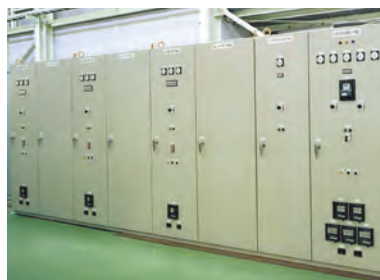
5.5KV受電盤(輸出)
